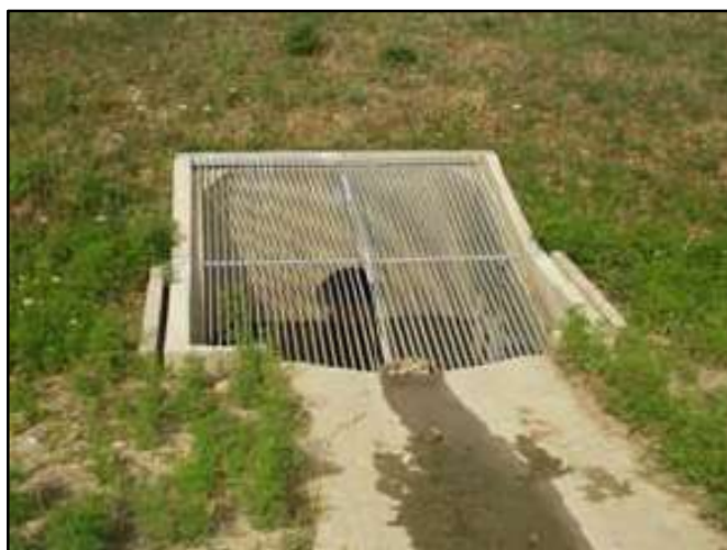
Figure 19 : Grille de protection sur ouvrage de sortie
